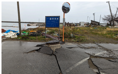
飛び出したマンホール
